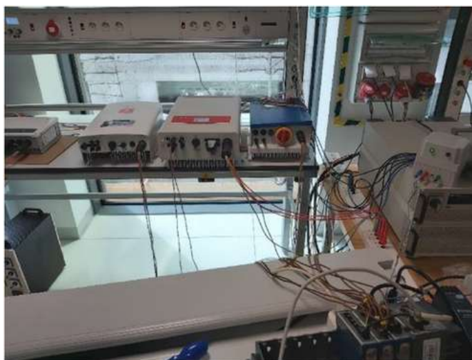
Rys. 10. Stanowisko pomiarowe do testowania komercyjnych falowników fotowoltaicznych [SzB-9].
