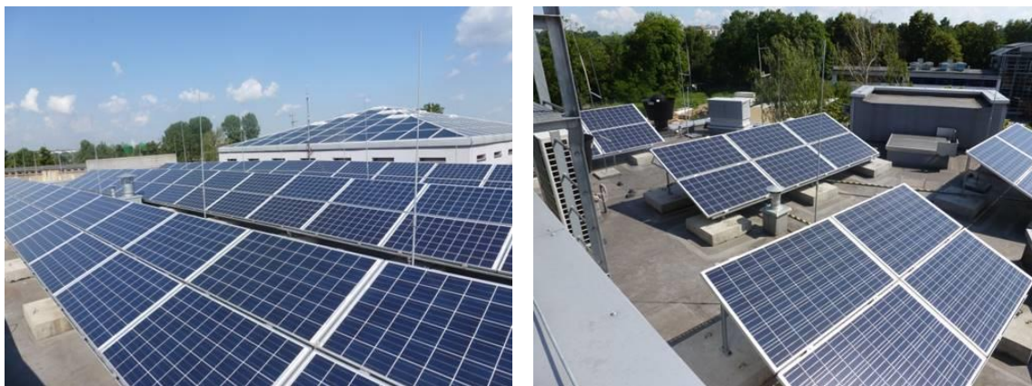
Rys. 6.4 TAURON Gliwice, zdjęcia paneli fotowoltaicznych zainstalowanych na dachu [12]
