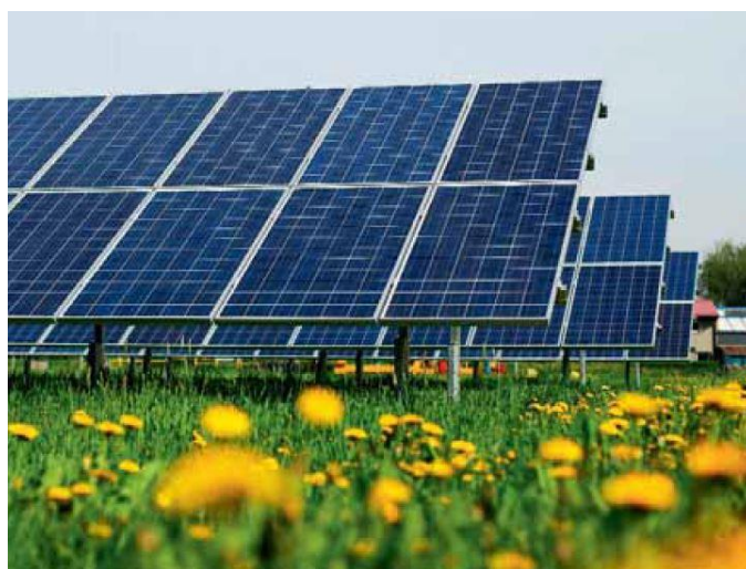
Rys. 7.2 Panele PV w oczyszczalni w Płaszowie
