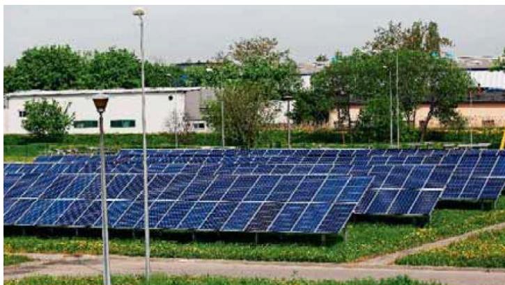
Rys. 7.1 Widok farmy PV na tle obiektów oczyszczalni ścieków w Płaszowie
