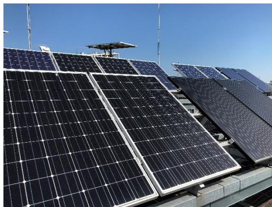
Rys. 5.16 Moduły PV Bruk-Bet Solar BEM 285Wp
