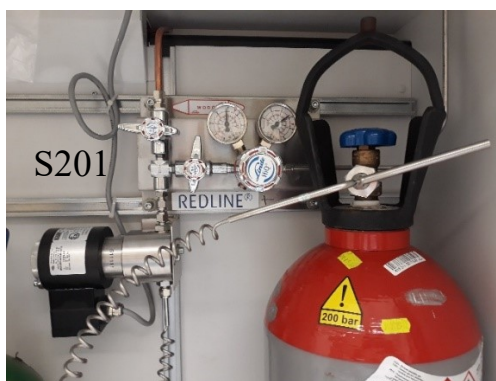
Rys. 6.1. Panel redukcyjny S201 wraz z elektrozaworem i butlą z wodorem
