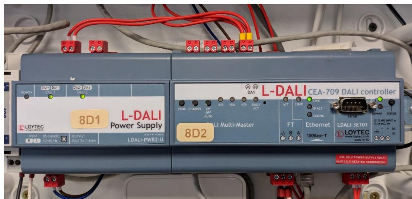
Rysunek 19. Sterownik Loytec L-DALI-3E101 wraz z zasilaczem magistrali DALI zamontowane w pomieszczeniu doświadczalnym.
