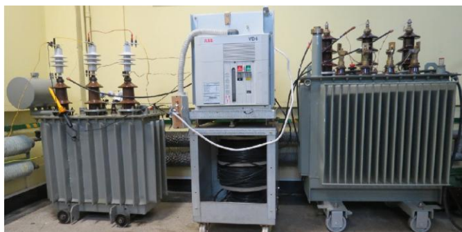
Rys. 4.1. Widok stanowiska doświadczalnego transformatora typu TNOSCT-250/15,75PNS o mocy znamionowej 250 kVA i napięciu znamionowym 15,75/0,4 kV
